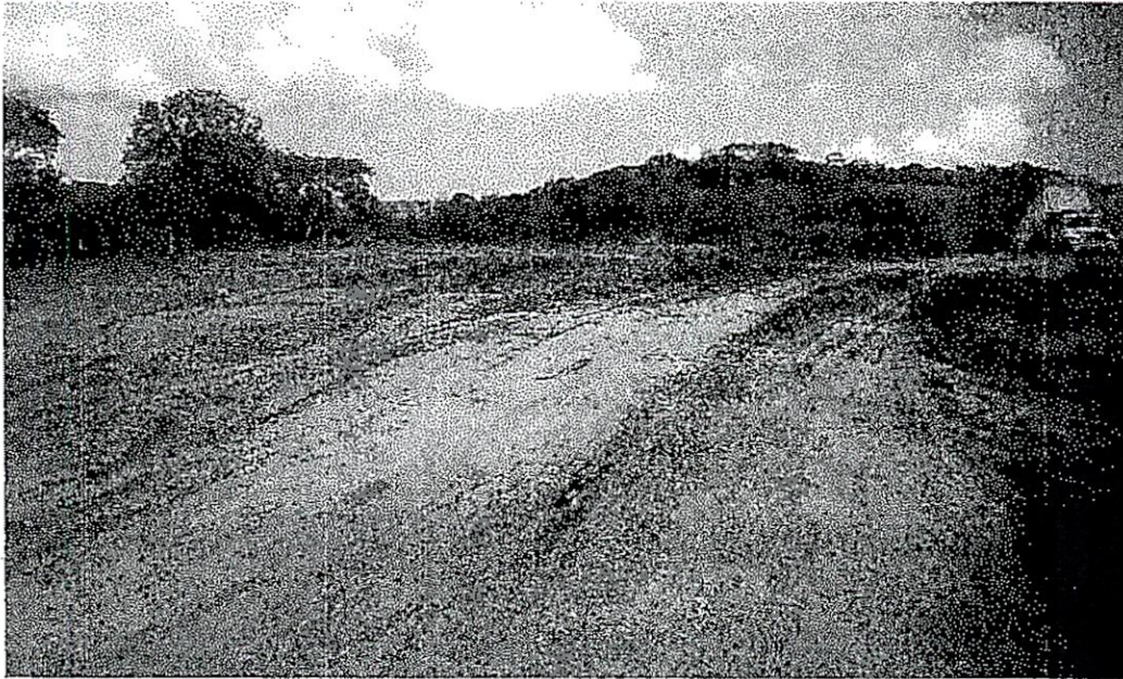
Relleno – Están realizando un relleno, No lo hace el titular
