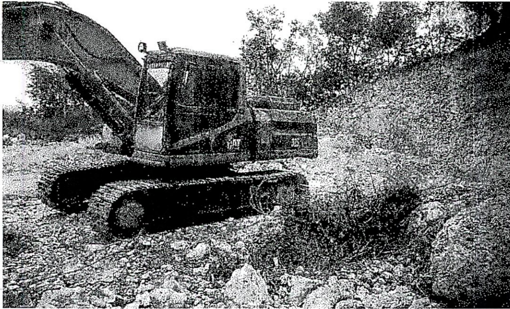
Frente de Explotación - Explotación ilegal
