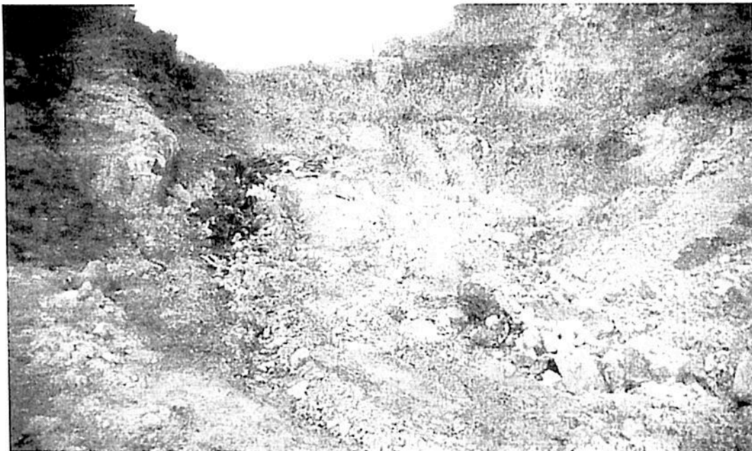
Foto No. 4 : Costado Izquierdo Frente 1- con evidencia de deslizamiento sobre la cara del talud. N: 1.107.286; E: 1.091.291; Z: 2.835 msnm
