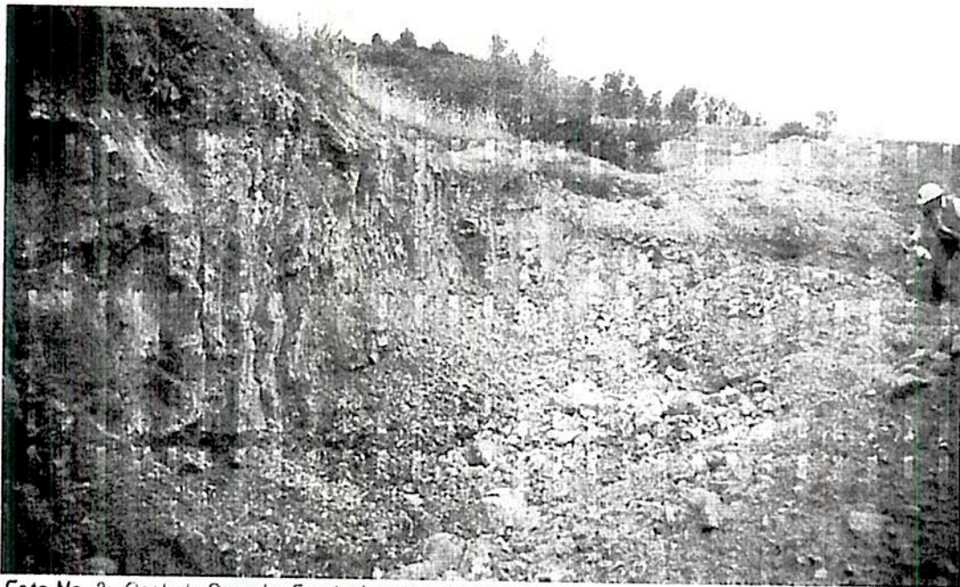
Foto No. 2: Costado Derecho Frente 1- con evidencia de corte y arranque sobre la cara del talud. N: 1.107.266, E: 1.091.283, Z: 2.837 msnm
