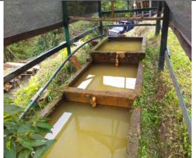
Sistema tratamiento de Aguas de la Mina "La Sierra"
