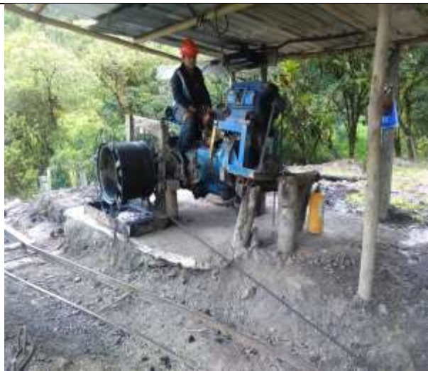
Malacate eléctrico 40 HP Mina "La Sierra"
